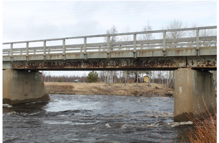
Illikaisen kosken ylittävä silta tarvitsisi kipeästi korjausta.
